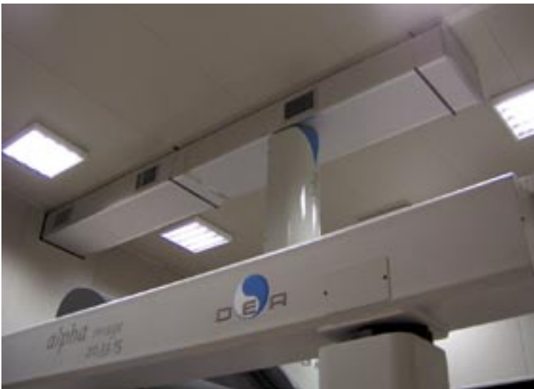
Impianto diffusione aria con bocchette orizzontali
