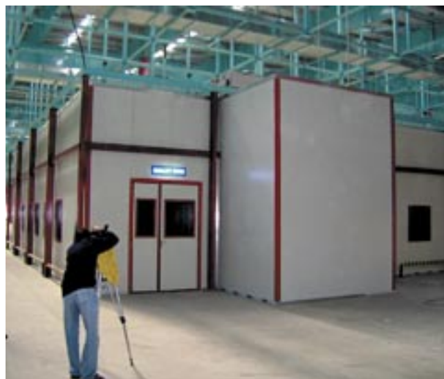
Impianto completo e locale tecnico esterno
