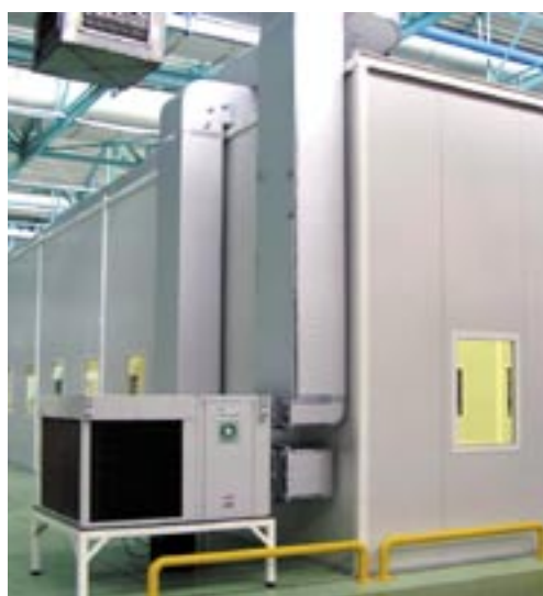
Gruppo di climatizzazione a terra
